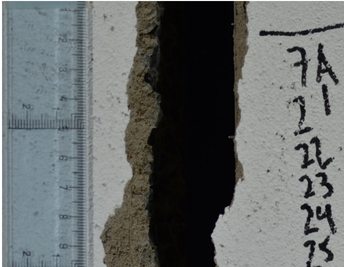
Bild 6-1. Slutligt brott efter provning.
